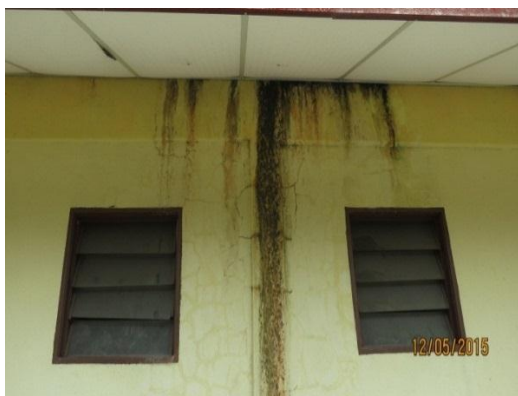
Gambar 3.14 Siling Diresapi Air Di Bahagian Tandas
