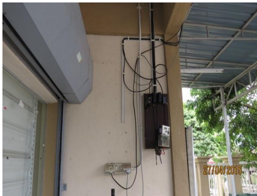
Gambar 3.16 Pendawaian Elektrik Tidak Kemas
